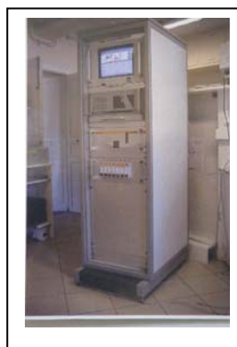
Baie EnergyMedor avec multiplexeur
