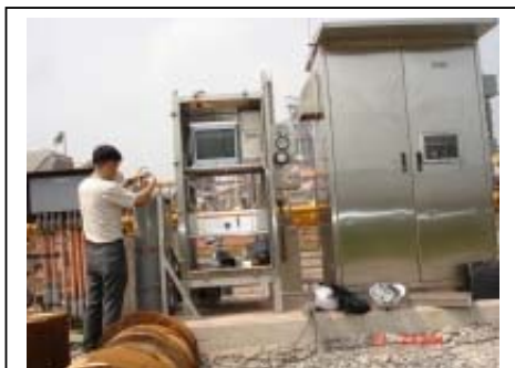
THTMEDOR dans une armoire antidéflagration en Corée du Sud
