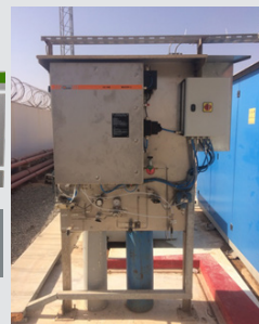
安装在生物气生产现场的ATEX防爆箱中的H2S/TS Medor分析仪
